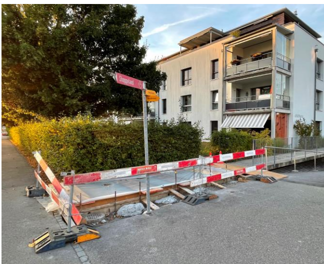
Spätsommer 2021: Bauliche Sanierung des Zugangs zu den Liegenschaften an der Lyss- strasse (1. Etappe)
